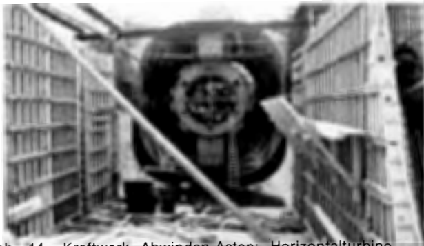
Abb. 14. Kraftwerk – Abwinden-Asten; Horizontalturbine Saugrohrauslauf
