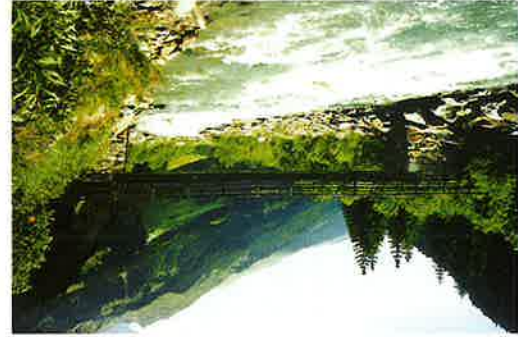
Abb. 2.38: Der Schmittensteg am unteren Ende des ASB Mellitzwald ist durch Tiefenerosion im Bereich der Brückenwiderlager in seinem Bestand gefährdet.
