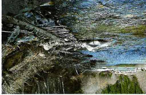
Abb. 3.2: Alte Verbaumung auf Holzpost. Durch Tiefenerosion wurde die Fundierung freigelegt.
