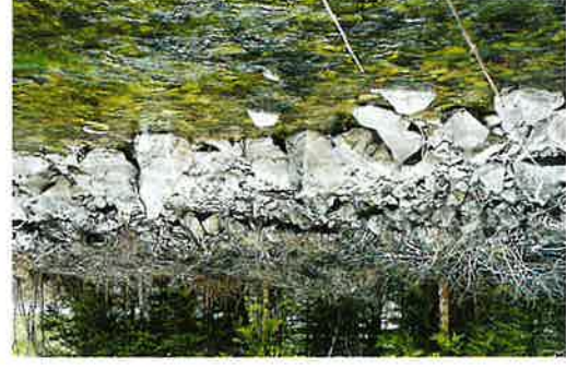
Abb. 2.37: Sohleintiefung unterhalb Zotten; Durch die Tiefenerosion wurde die Steinschichtung unterwaschen; sie rutscht in den entstandenen Kolk nach.
